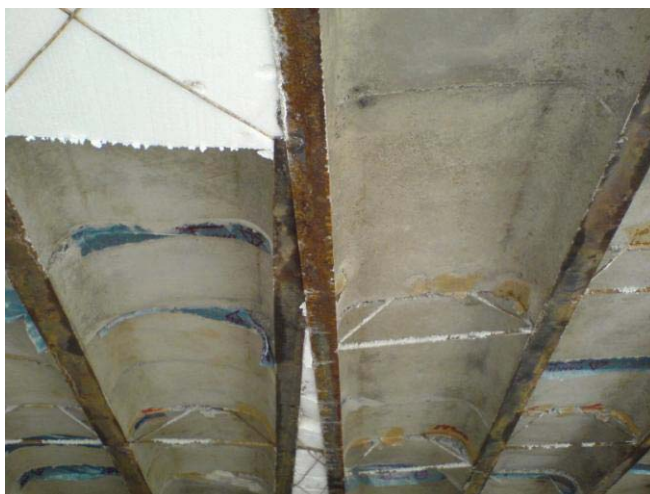
(شکل ۲) اجرای نادرست کلاف عرضی با میلگرد در سقف‌های گرمیت کامپوزیت
