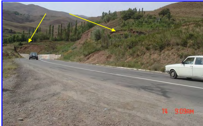
شکل 12: حفاری در دامنه ها و تاثیر احداث جاده و ایجاد لغزش بر روی دامنه ها
