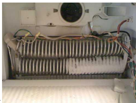
گرفتگی لوله مویی باعث یخ زدن قسمتی از اواپراتور شده
