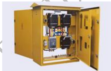
نمونه ای از کلید - فیوز نصب شده در تابلو توزیع برق
