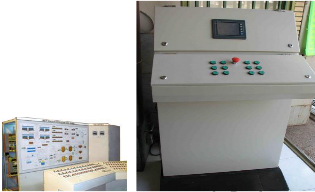
تابلو های حفاظت و کنترل
