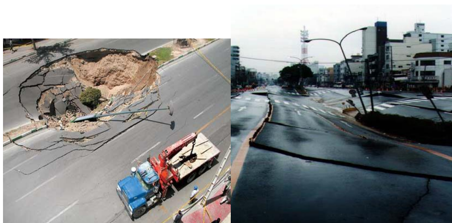
شکل (۴) نشست ناشی از تخلیه آبهای زیرزمینی
