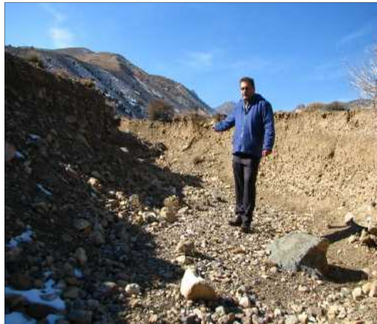
شکل (8) بستر رودخانه بلافاصله پس از سرریز
