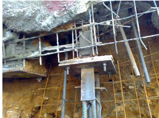
شکل (۱۴) عدم نصب میلگرد انتظار در مرحله تاپ و نصب این میلگردها در زمان نصب لتیس بنج
