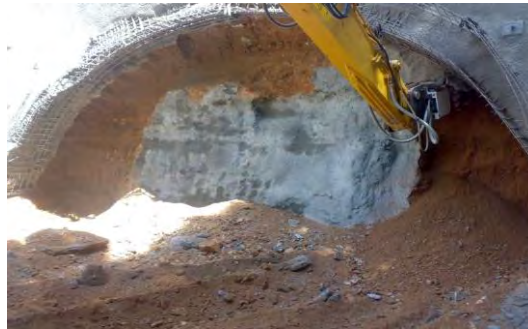
شکل (۲) روش صحیح حفاری و نحوه آغاز حفاری تونل امکان ایجاد همزمان موقعیت کار برای دو کارگر در دو طرف باعث سریع‌تر شدن کار می‌شود
