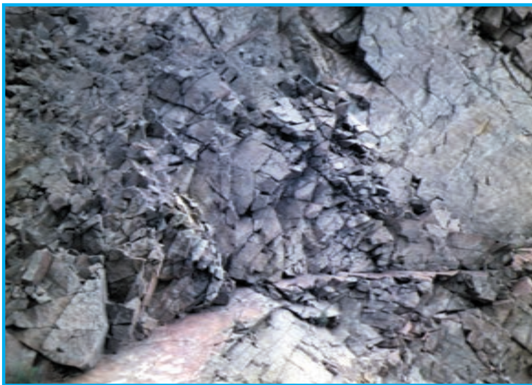
شکل ۱۷- هواز دگی فیزیکی بر اثر یخ بندان
