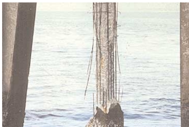
شکل ۲: پایهٔ بتنی قبلاً تعمیر شدهٔ یک پل در فلوریدا
