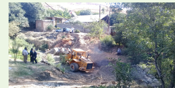
♦ شروع عملیات اجرای دیوار حائل و بل سنگی بر روی رودخانه کبان رود جهت احداث راه ارتباطی جدید شهر
