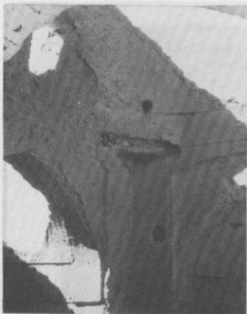
برد - منطقه شهدای قهرج - لب بند تریه با چوب است که موریانه آنرا خورده و اکنون نشانه‌ها آثار آن دیده می‌شود ▲
