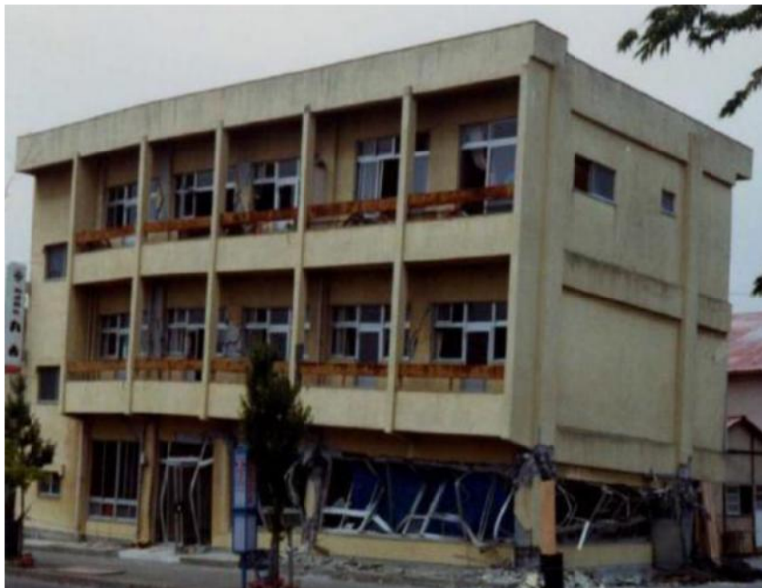
شکل (6): تخریب ستون های گوشه ناشی از پیچش
