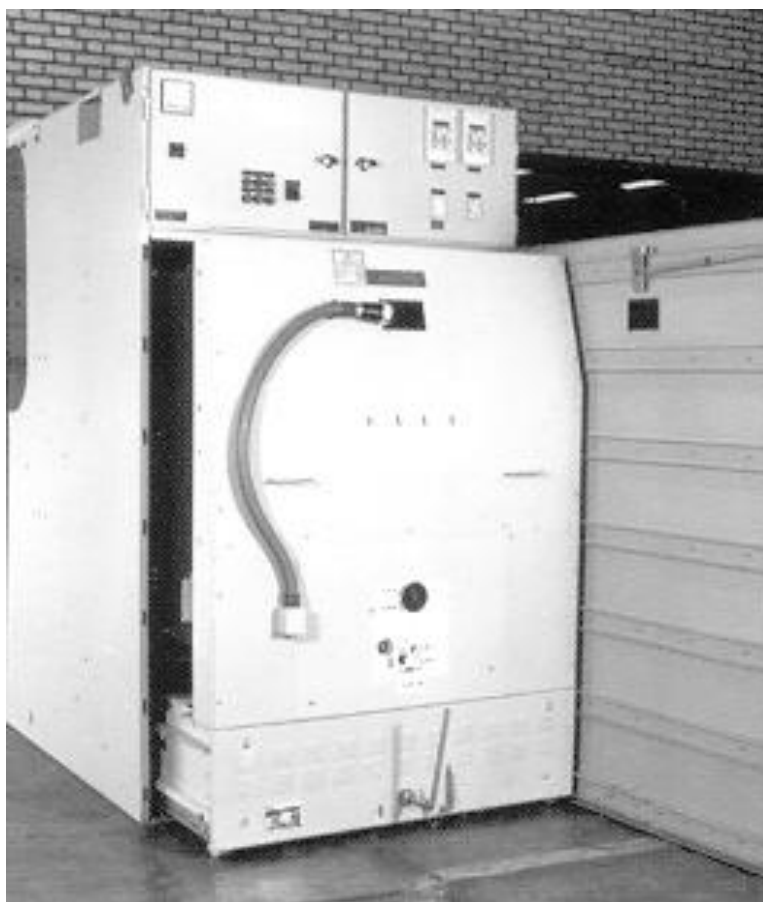
شکل (۱۵): تابلوی توزیع ۲۰ کیلوولت با کلید دژنکتور کشوئی و اینترلاک بین کلید و بدنه تابلو
