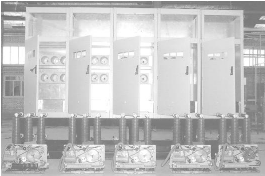
شکل (۲): بدنه تابلوی فلزی ۵ سلول یک پارچه
