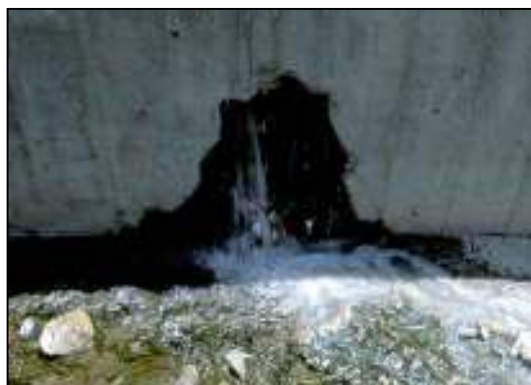
تخریب دیواره مسیل گلابدره و ورود زباله به داخل مسیل
