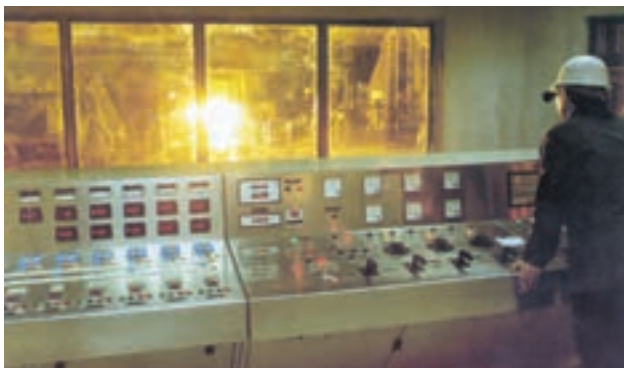
اتاق کنترل نیروگاه برق
