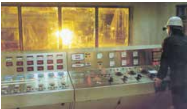
اتاق کنترل نیروگاه برق
