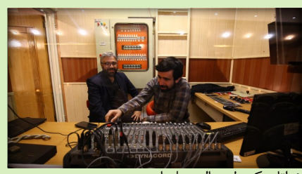
* اتاق کنترل سالن جلسات
