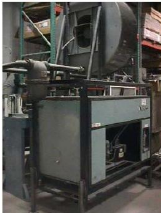
شکل ۳۷- نمایی از یک خشک کن
