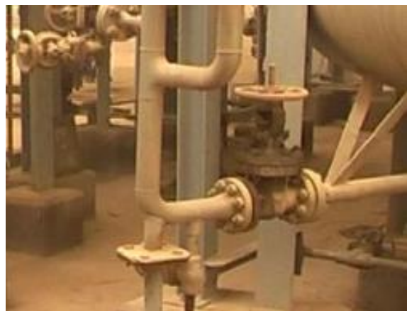
شکل ۳۴ و ۳۵- تصویر یک شیر کنترل و چند گیج برای کنترل سیستم
