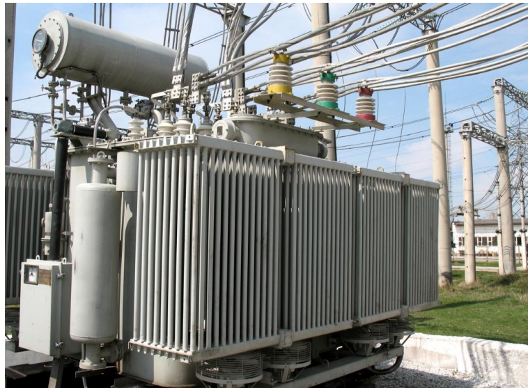
ترانس فوق توزیع (ولتاژ ۶۳ kV و ۱۳۲)
