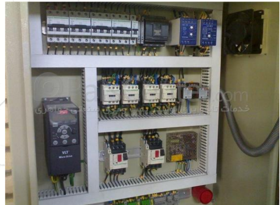
نمایی از داخل یک تابلوی برق و انواع فیوزها و کلیدها و رله ها
