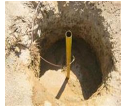
چاه ارت دوغاب ریزی شده
