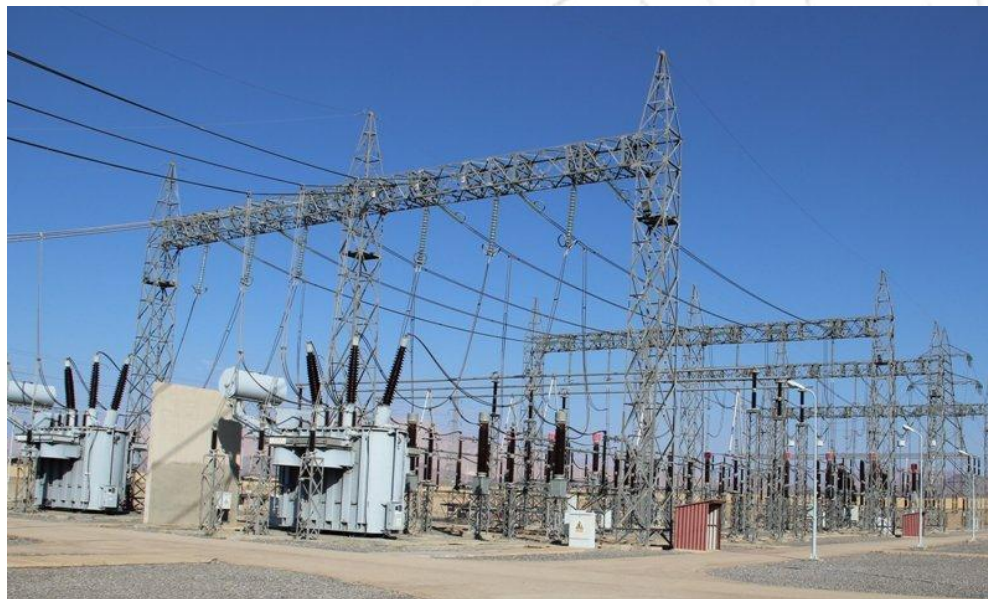
پست انتقال ۴۰۰ کیلوولت فیروزکوه
