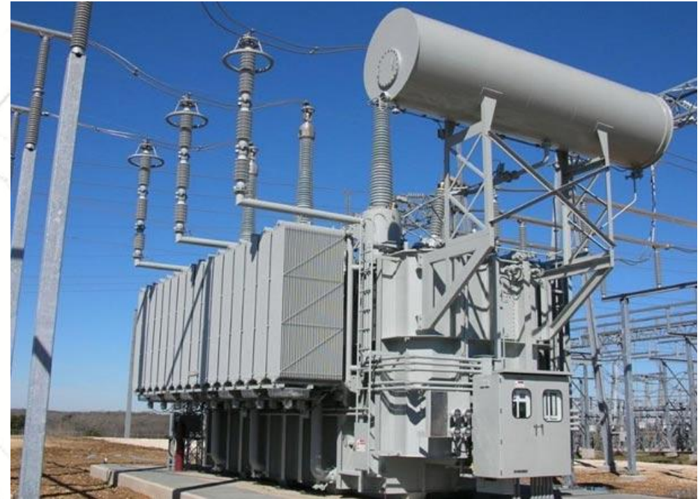
ترانس انتقال (ولتاژ ۲۳۰ kV و ۴۰۰)
