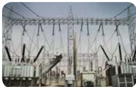
شکل ۱۶- پست انتقال برق
