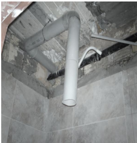
لوله تهویه سرویس بهداشتی
