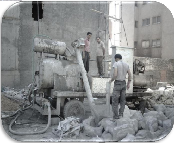
نمایی از دستگاه بتن ساز (بتن سبک)
