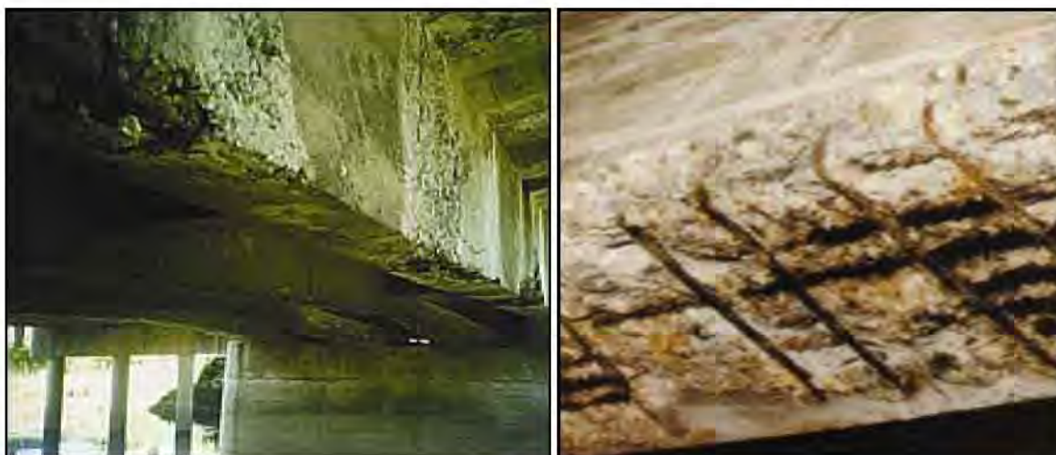
شکل ۲-۴-۱- نمونه‌هایی از آسیب‌دیدگی تیرهای بتنی
