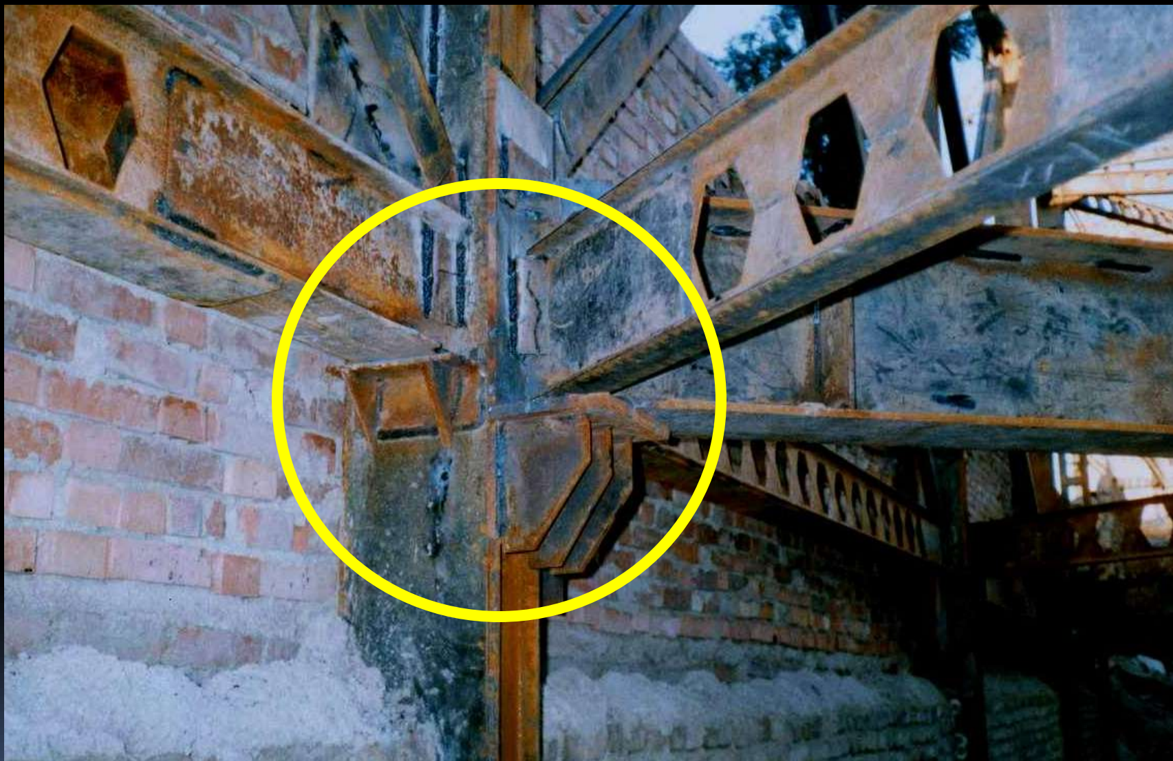
اتصال تیرهای متعدد از اطراف به ستون و کمبود مقاومت برشی چشمه اتصال
