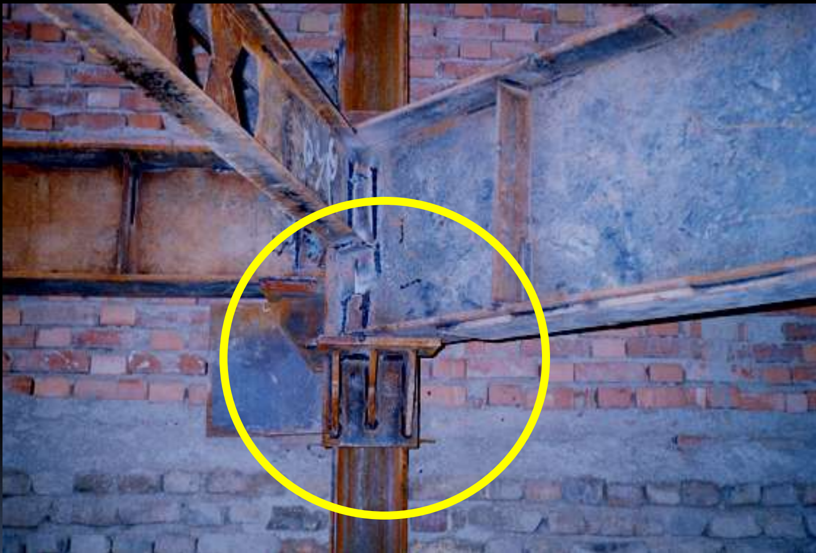
اتصال تیرهای متعدد از اطراف به ستون و کمبود مقاومت برشی چشمه اتصال
