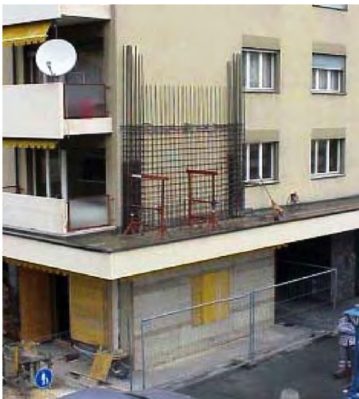
دیوار پیرامونی جدید بتن مسلح که در جلوی دیوار موجود بتن‌ریزی و اجرا می‌گردد.
