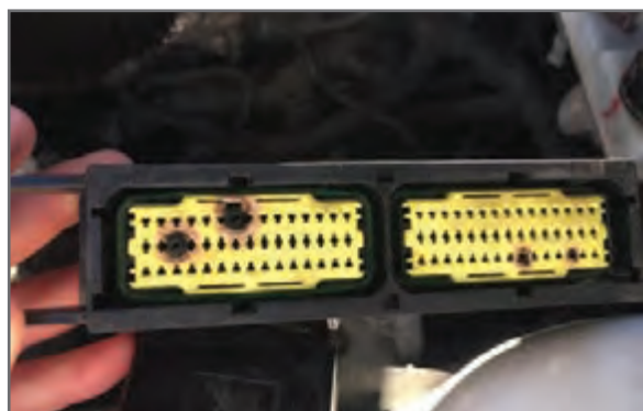
شکل ۲۷- مهم ترین خرابی های کانکتورها
