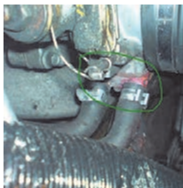
شکل ۶۱- نشتی از لوله ها و پولک اطراف سیلندر
