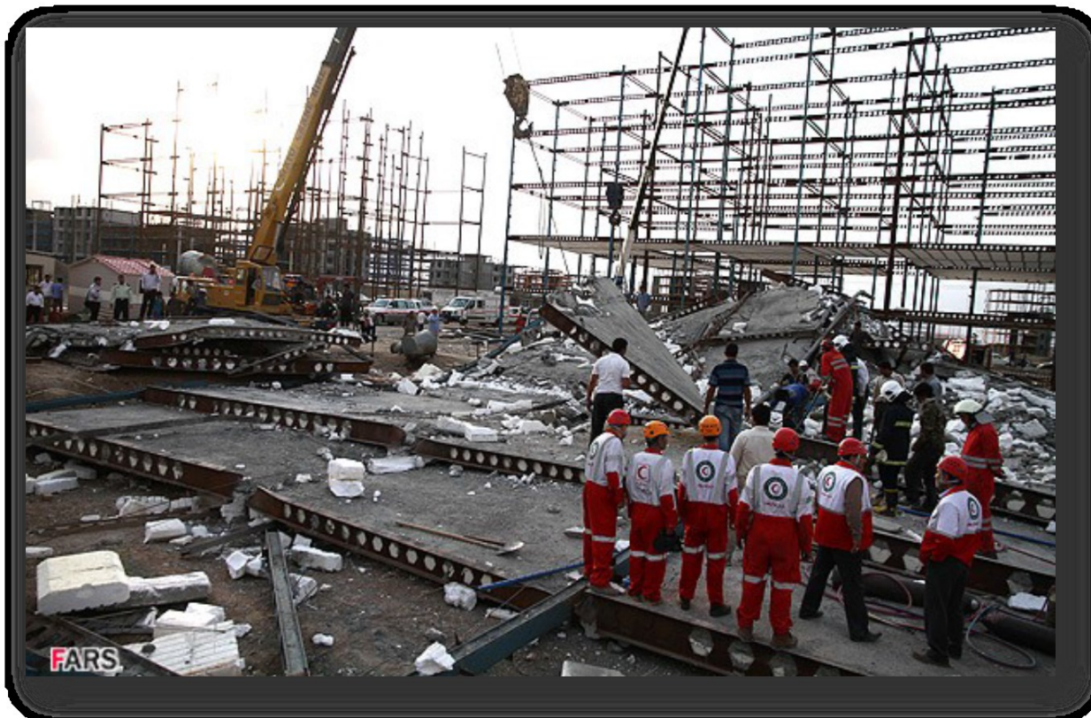
شکل (۲۲) اجرای سقف بدون اجرای دیوار برشی باعث ناپایداری و فروریزش ساختمان شده است.
