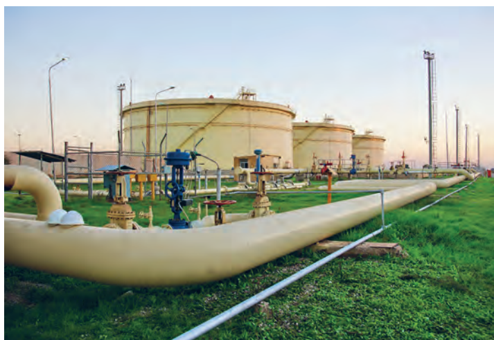
شکل ۲۱- نمایی از خطوط انتقال سوخت
