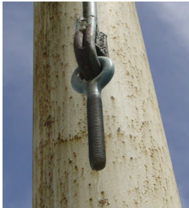
شکل ۳- شکست ترد بست‌های قورباغه‌ای مهاربندها [۱]
