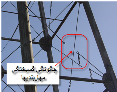
شکل ۴- گسیختگی مهاربندهای جانبی سازه [۱]
