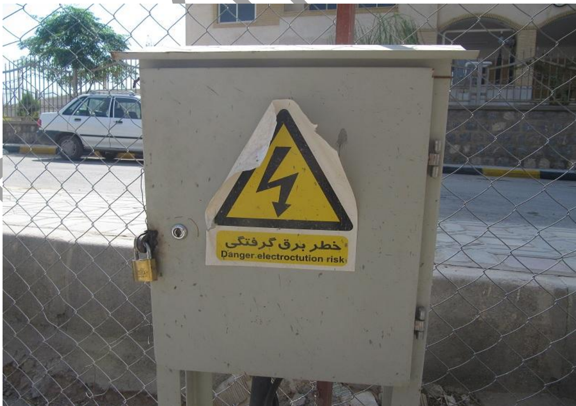
شکل ۱۱- تابلوی ایمنی خطر برق گرفتگی در محیط کارگاه
