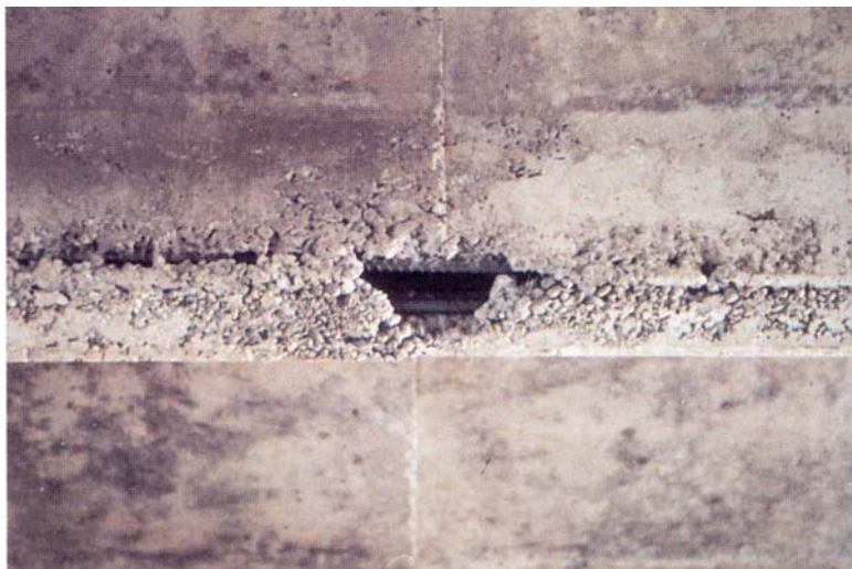
شکل ۸ نمونه‌ای از نحوه نامناسب تراکم بتن
