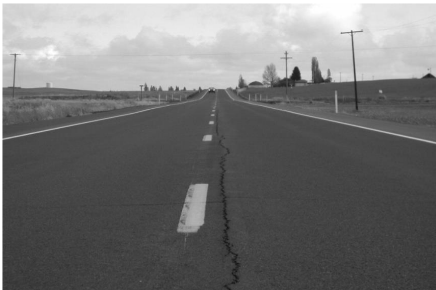
شکل شماره ۳: ترک‌خوردگی طولی در روسازی آسفالت
