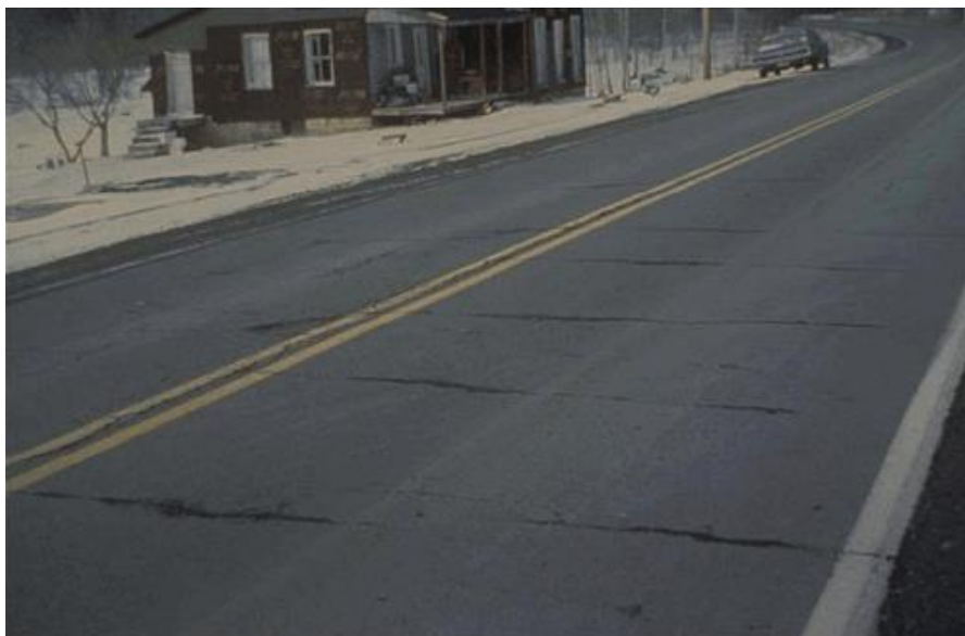
شکل شماره ۴: ترک‌خوردگی عرضی در روسازی آسفالتی
