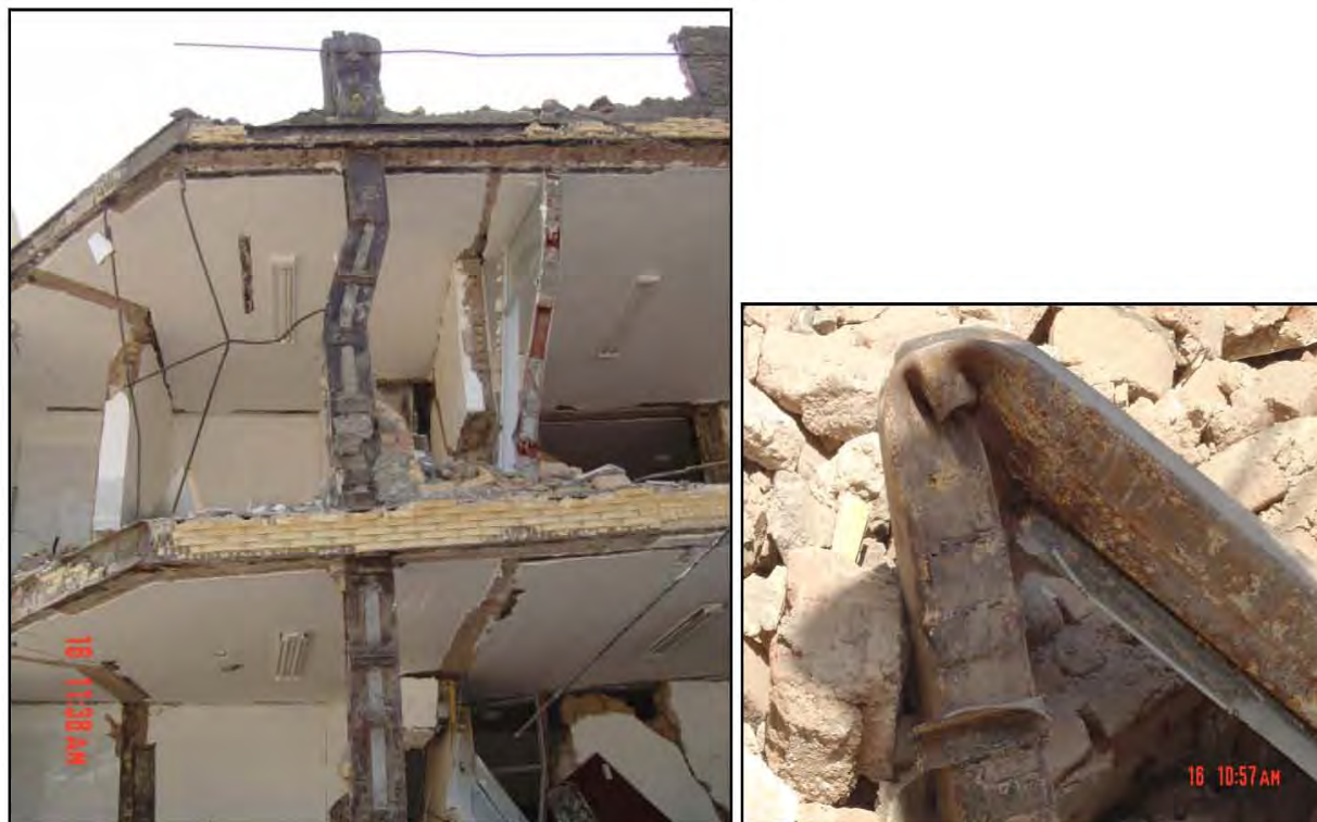
شکل ۲-۵-۱۹- نمونه‌ای از خرابی ستون‌های فولادی
