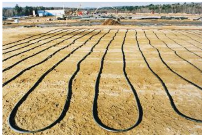
شکل ۴ سیستم گرمایش آبی، برای آب شدن یخ بستر شلنگ‌های گرمایش بر روی زمین قرار داده شده‌اند.
