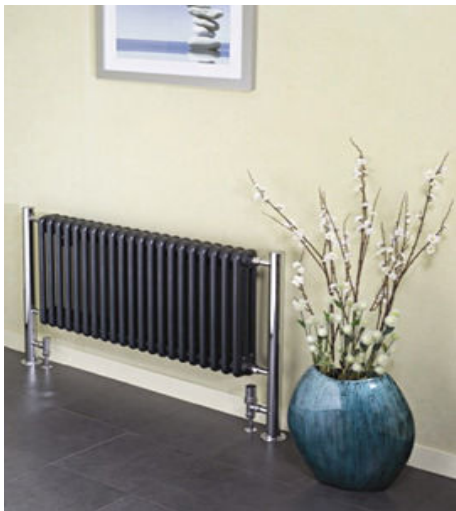
شکل ۱۵: شوفاژ در پایین اتاق‌ها نصب می‌شود.
