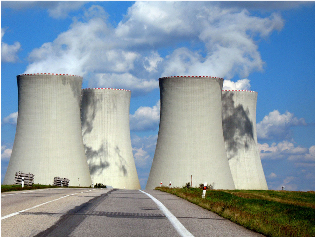
شکل ۲۸: برج‌های خنک کننده در نیروگاه‌ها
