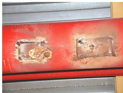
شکل ۸- محل‌های خوردگی لوله آب آتش‌نشانی و جوشکاری آنها
