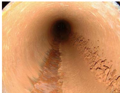
شکل ۶- خوردگی در لوله آب آتش‌نشانی (قسمت درونی)
