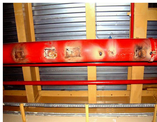
شکل ۷- خوردگی لوله آب آتش‌نشانی و محل‌های جوش
