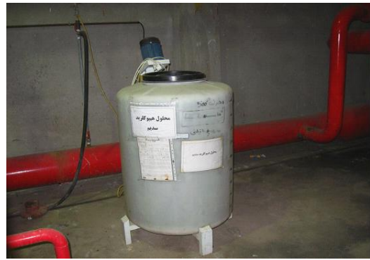
شکل ۹- سیستم تزریق هیپو کلرید سدیم
