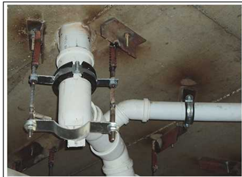
شکل ۸ : نحوه بست گذاری سیفون های گروه صنعتی وحید در زیر سقف
