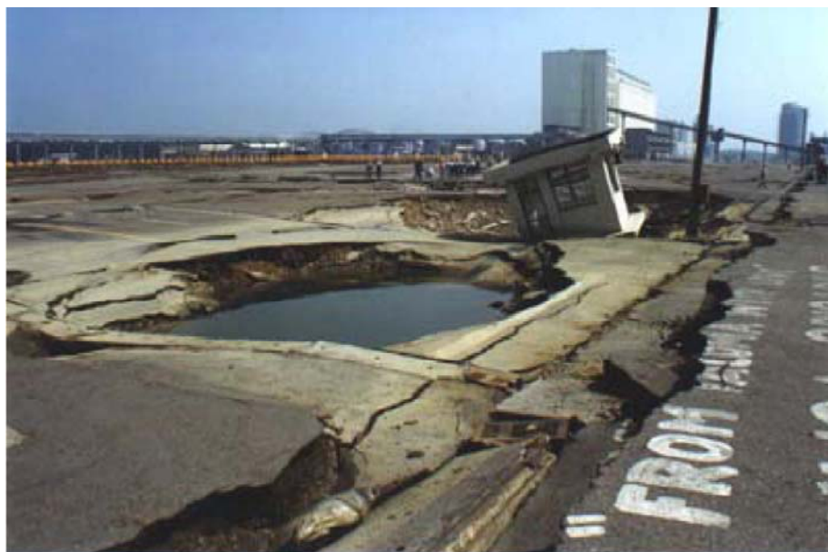
شکل ۱-۱۶- ایجاد حفره و تغییر شکل زمین پشت دیوار ساحلی در بندر Taichung در زلزله‌ی Chi Chi
