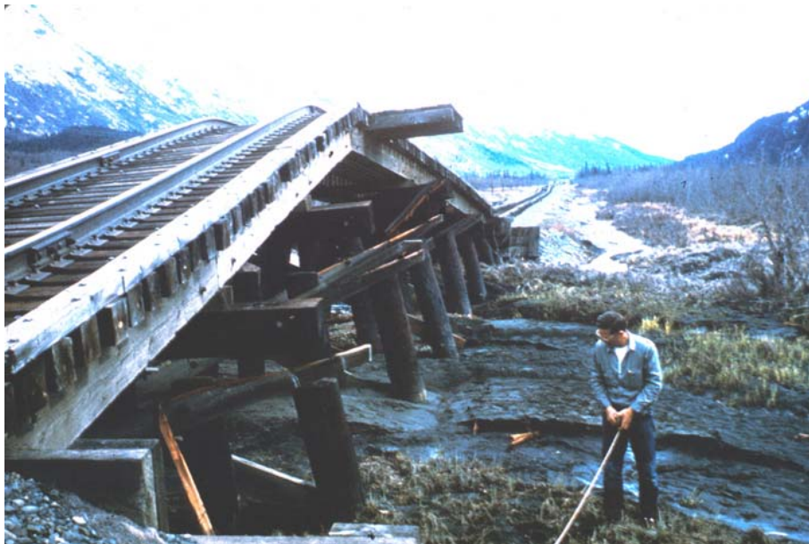
شکل ۴-۱- خرابی پل راه‌آهن واقع بر روی دریاچه‌ی Kenai در طی زلزله‌ی آلاسکا
