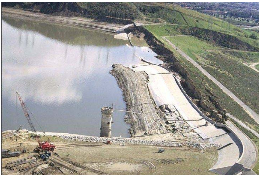
شکل ۸-۱- خرابی سد پایینی San Fernando پس از وقوع زلزله
