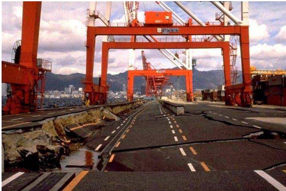
شکل ۱-۱۲- گسترش جانبی دیوار ساحلی در جزیره‌ی Port Island در زلزله‌ی کوبه
