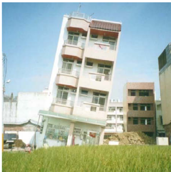
شکل ۱-۱۵- گسیختگی پی در اثر روانگرایی در شهر Yuanlin در زلزله‌ی Chi Chi
