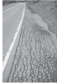
Edge fatigue crack
