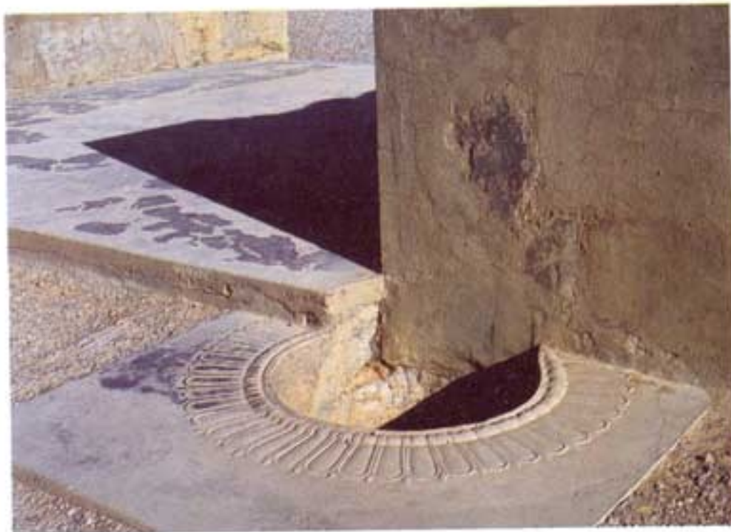
۴۸. آپادانا: جای پاشنه در دو لنگه و بسیار بزرگ شمال غربی تالار که به صورت گل‌واره‌ای زیبا و عمیق درآورده شده است.
