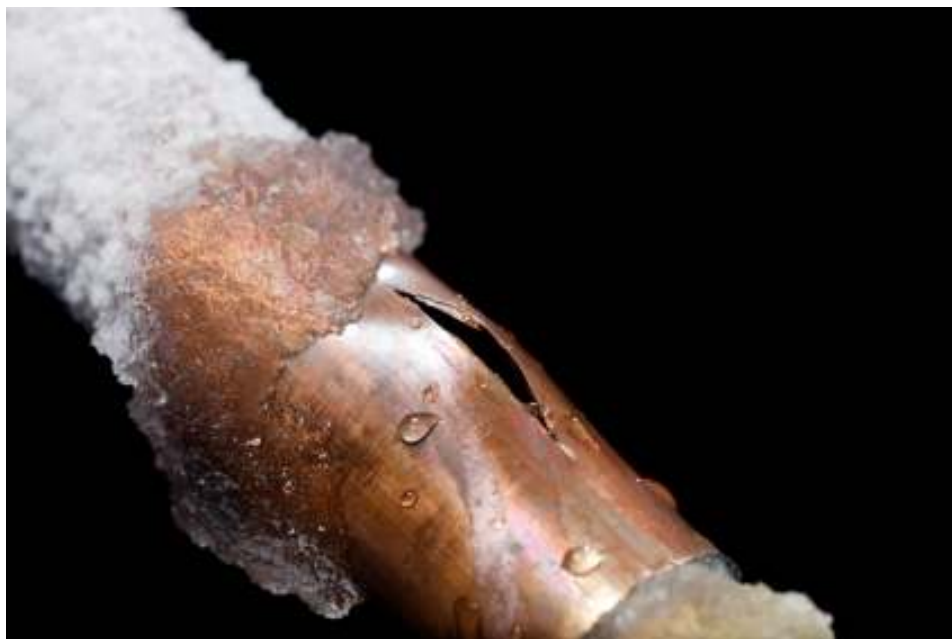
شکل ۲۸: ترکیدگی ظرف یا لوله در اثر انبساط آب
