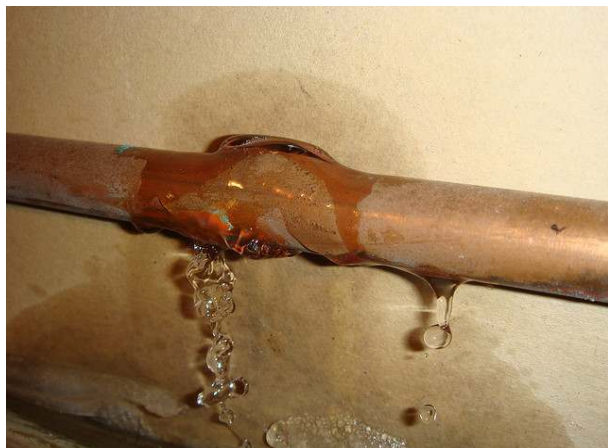
شکل ۲: لوله ی آب که به خاطر یخ زدگی ترکیده است.
