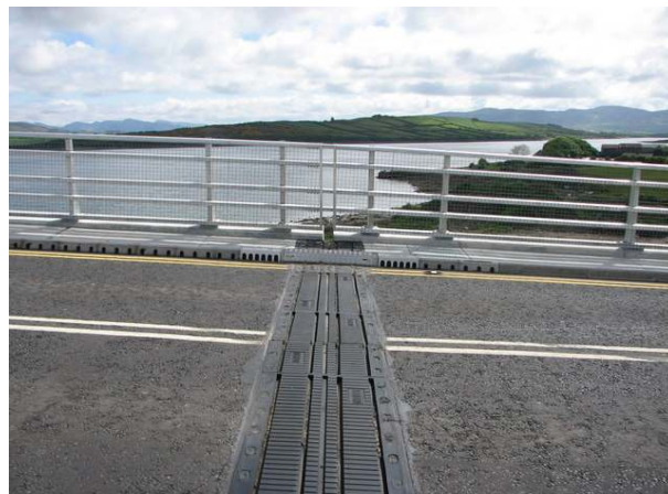
شکل ۱: شکاف یک پل که پوشیده شده است.
