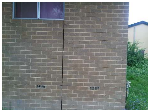
شکل ۳: شکاف قرار داده شده برای ساختمان.
