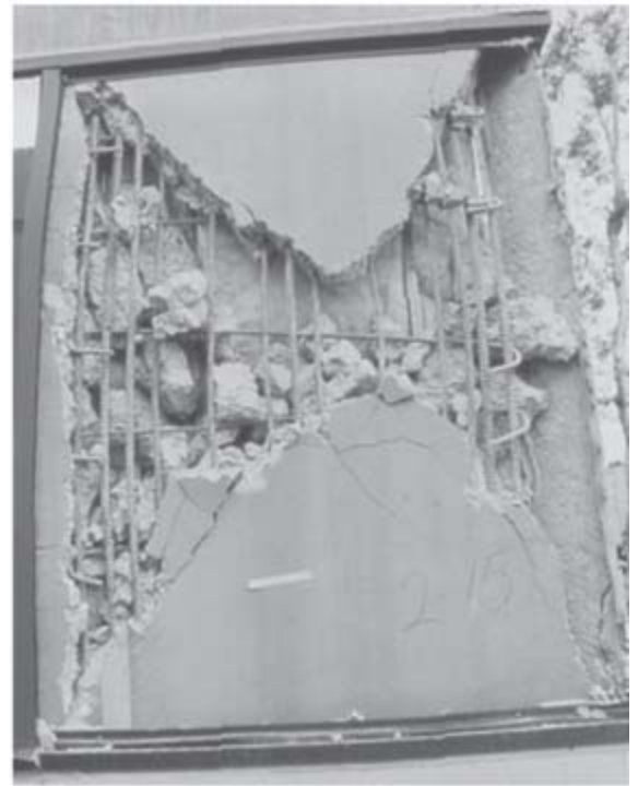
در شکل فوق به دلیل پر فولاد بودن دیوار، میلگردها تسلیم نشده اند.
