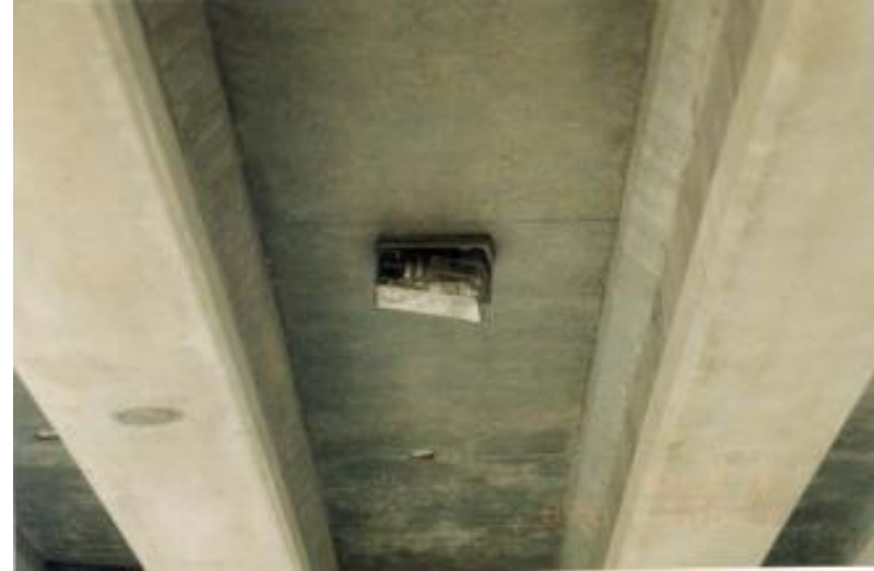
لکه جزئی آب در زیر تیر
