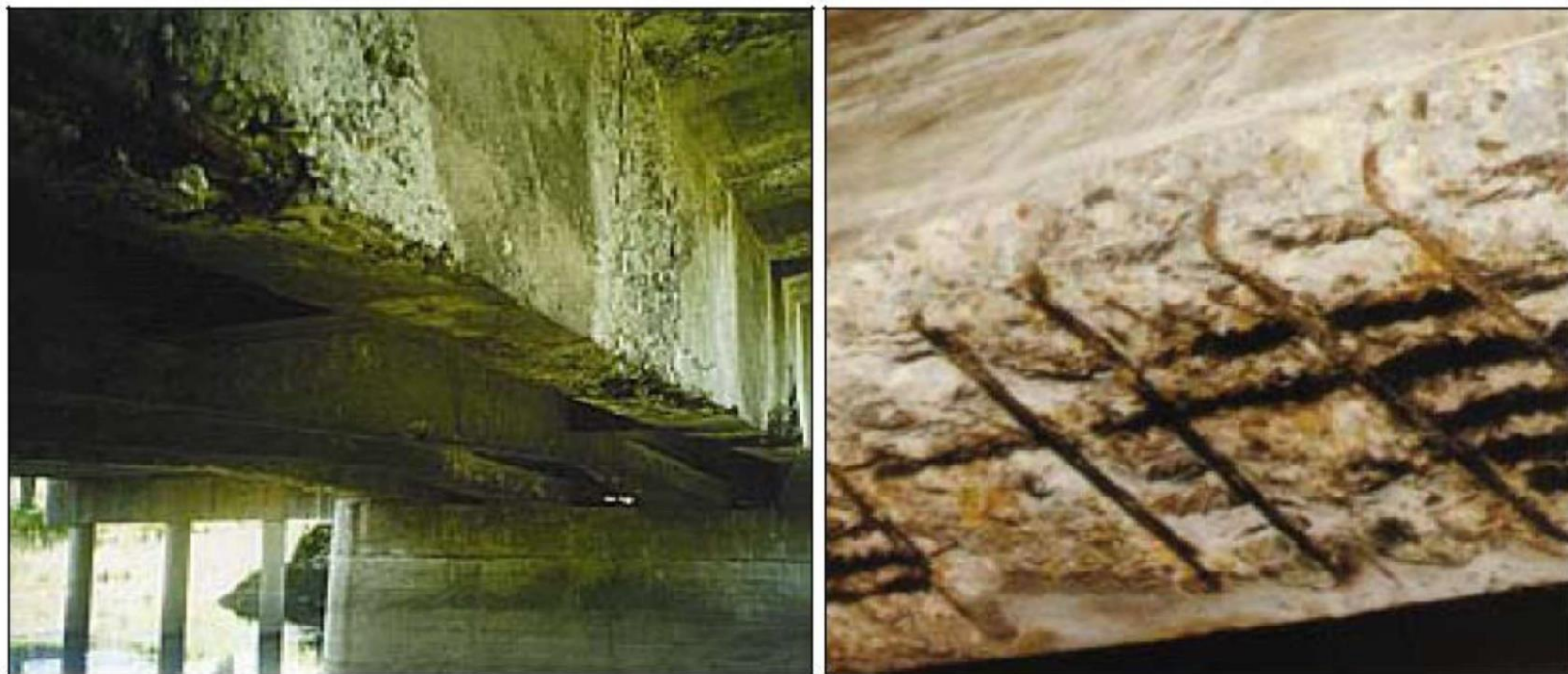
شکل ۲-۴-۱- نمونه‌هایی از آسیب‌دیدگی تیرهای بتنی
