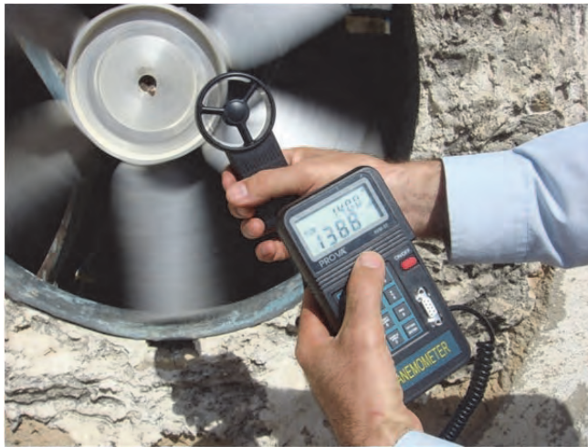
شکل ۱۲- کنترل خروجی هواکش‌ها براساس نیاز پرند
