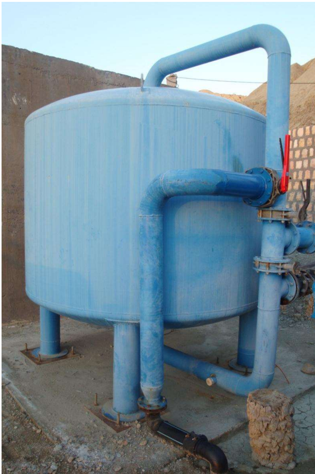
شکل ۵-۴- آب شیرین کن شهر فین - فیلتر شنی جهت پیش تصفیه آب قبل از فیلترهای RO
