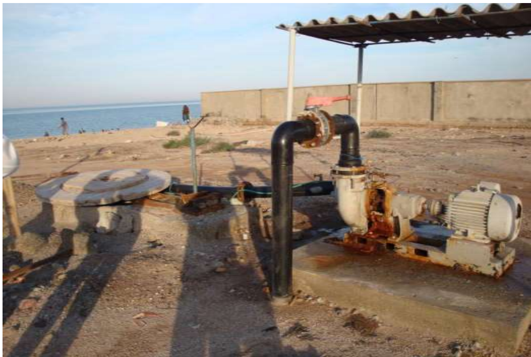
شکل ۵-۲۲- آب شیرین کن جزیره هرمز - چاه آب خام و تاسیسات استحصال آب از آن
