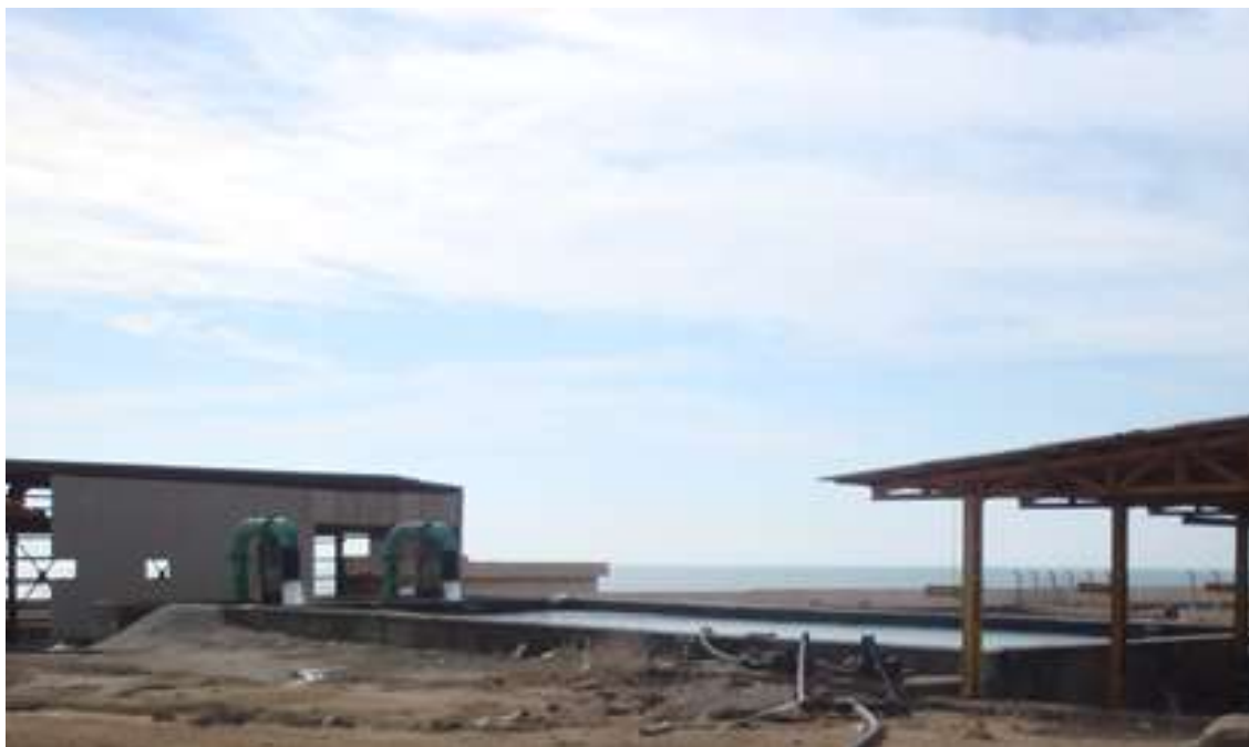
شکل ۵-۱۶- آب شیرین کن بندر لنگه - واحد شماره ۲ - مخزن ذخیره آب خام
