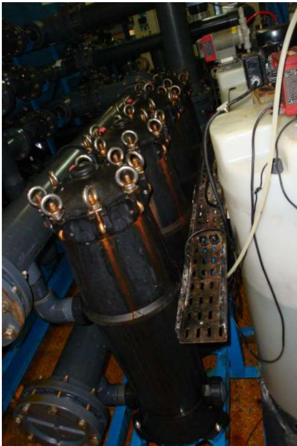
شکل ۵-۲۶- آب شیرین کن جزیره هرمز - زیر واحدهای ۸۰۰ متر مکعبی - فیلترهای کارتریج
