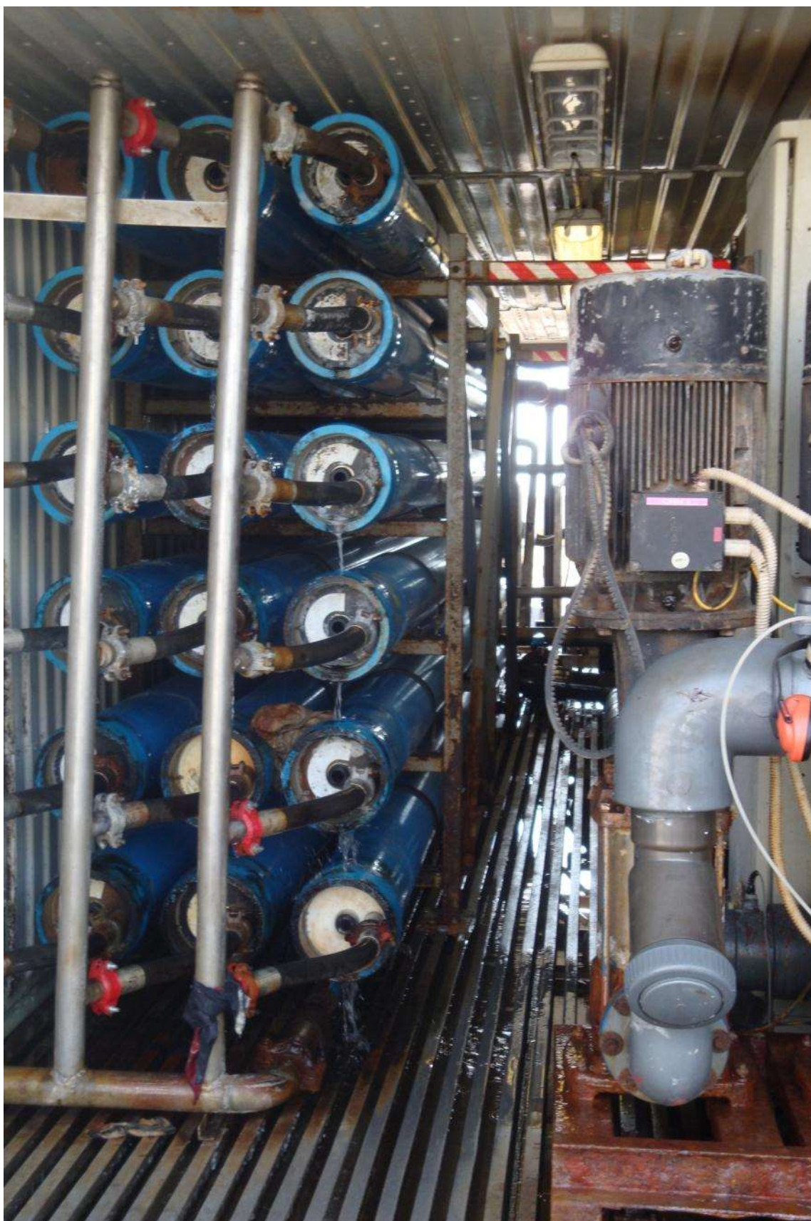
شکل ۵-۱۳- آب شیرین کن بندر لنگه - واحد شماره ۱- وسل های RO
