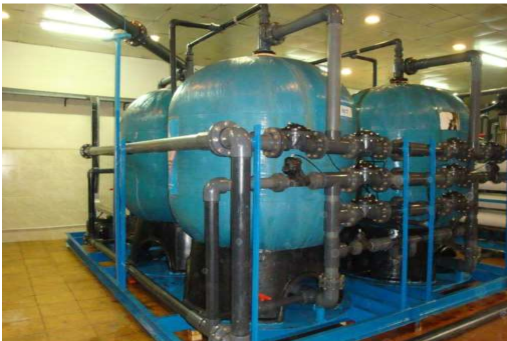
شکل ۵-۲۴- آب شیرین کن جزیره هرمز - زیر واحدهای ۸۰۰ متر مکعبی - فیلترهای شنی
