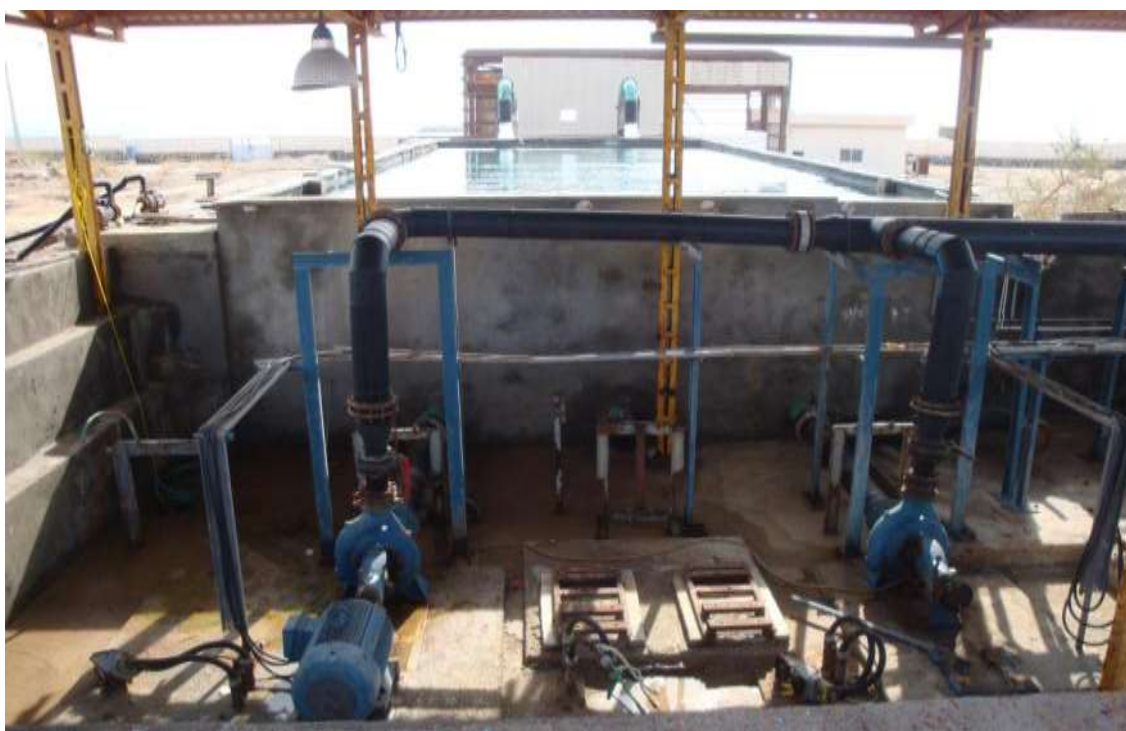
شکل ۵-۱۷- آب شیرین کن بندر لنگه - واحد شماره ۲ - تاسیسات تزریق کلر و پمپاژ آب خام
