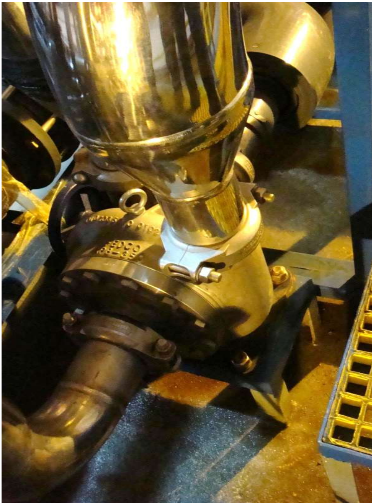
شکل ۵-۶۵- آب شیرین کن درگهان - Energy Recovery Turbine
