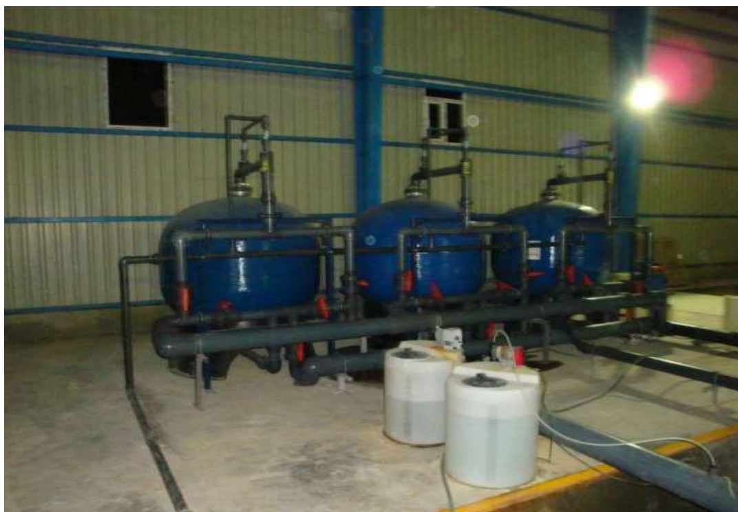
شکل ۵۲- آب شیرین کن سوزا - فیلترهای شنی (واحد تمام اتوماتیک)
