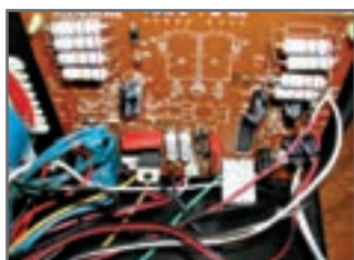
شکل ۱۳۲- برد الکترونیکی و کنترل شدت هوای فشرده
