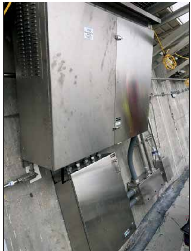
Fig. 33 Rectifier Control Panel Box
