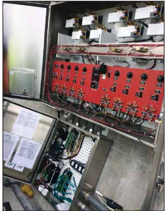
Fig. 32 Rectifier Control Panel
