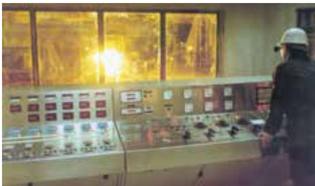
اتاق کنترل نیروگاه برق
