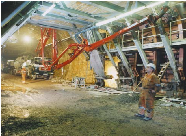
شکل ۴-۱۰-۷- پمپ بتن تونل
