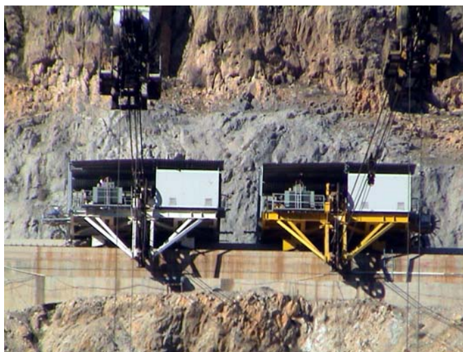
شکل شماره ۶-۶-۴ - نمایی نزدیک از واگن‌های اصلی سیار جرثقیل کابلی موازی کارون ۳ (جناح راست)
