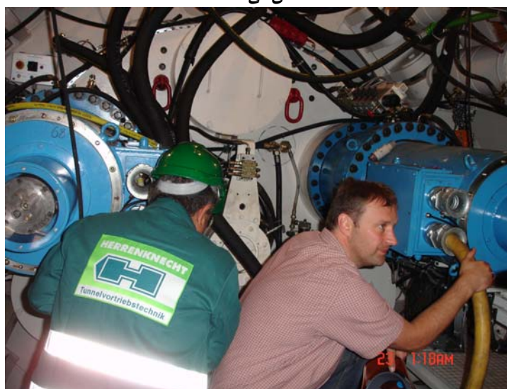
شکل ۳-۳-۳۷. فضای داخلی اتاقک جلویی کلگی. در تصویر موتورهای نصب شده دیده می‌شود.
